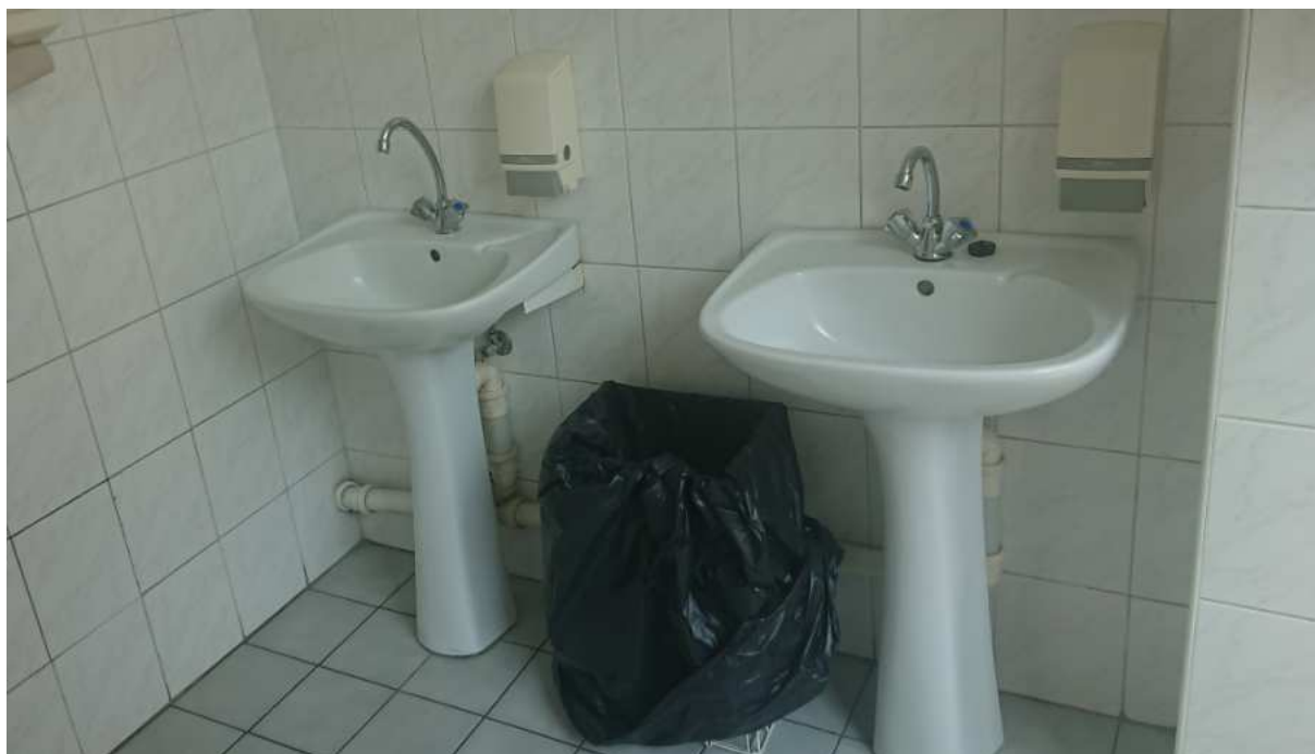
Fotografia 26 Istniejące baterie umywalkowe
