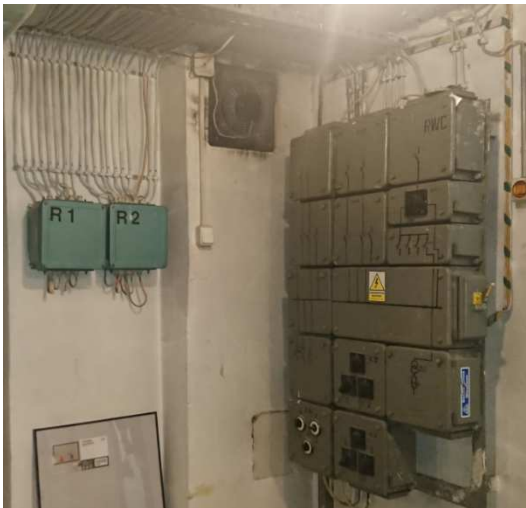
Fotografia 6 Rozdzielnia elektryczna w węźle c.o.
