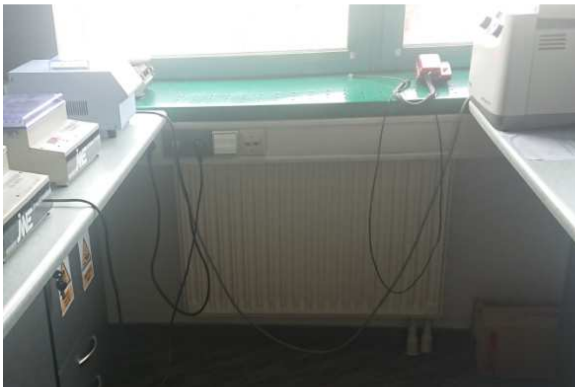
Fotografia 3 Wygląd typowego grzejnika w pomieszczeniu biurowym
