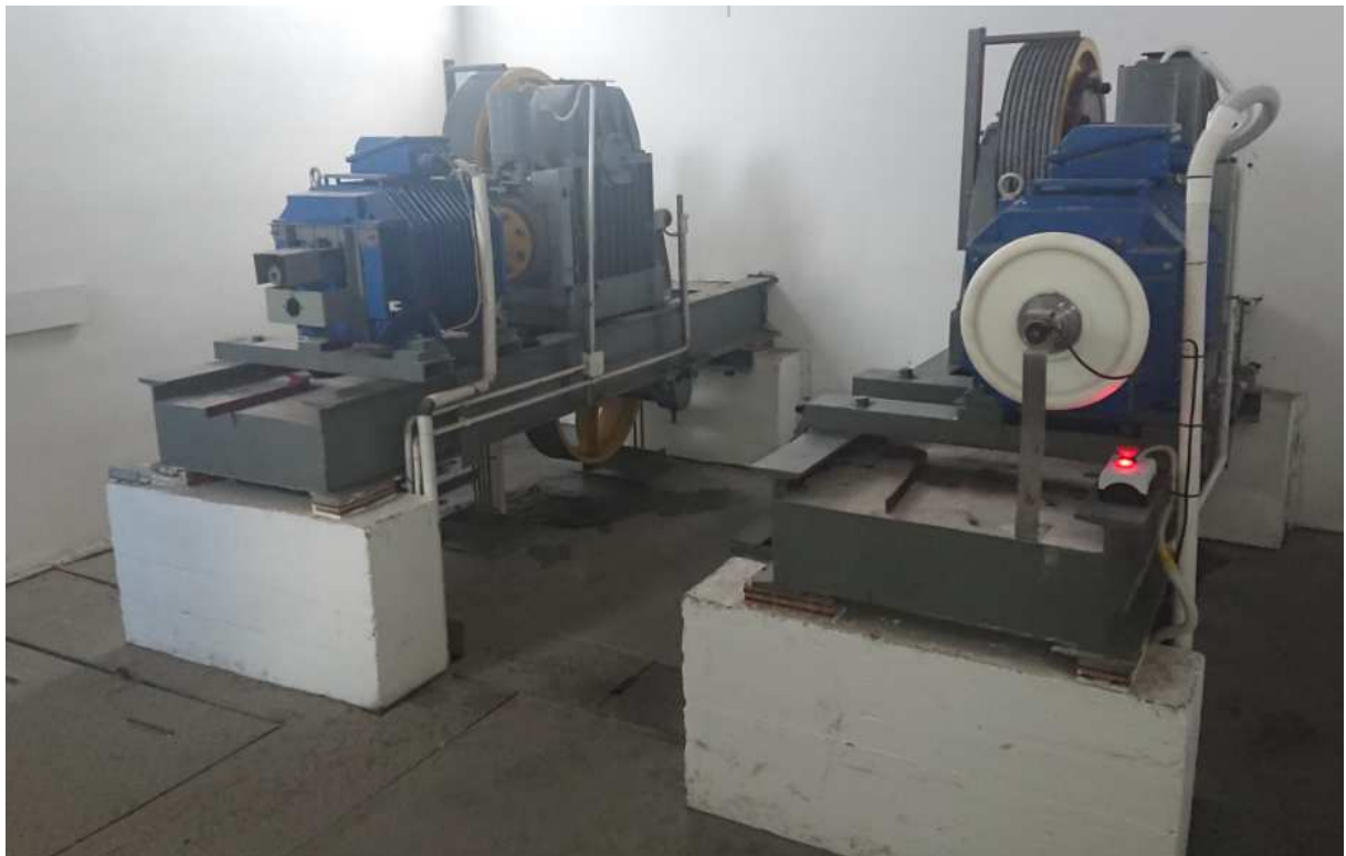
Fotografia 24 Napędy wind elektrycznych nr 2 i 3
