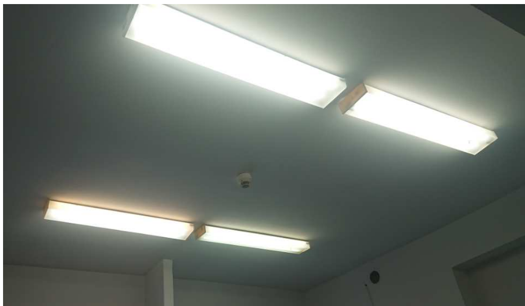
Fotografia 19 Przykładowy wygląd lamp – głównie w pomieszczeniach biurowych
