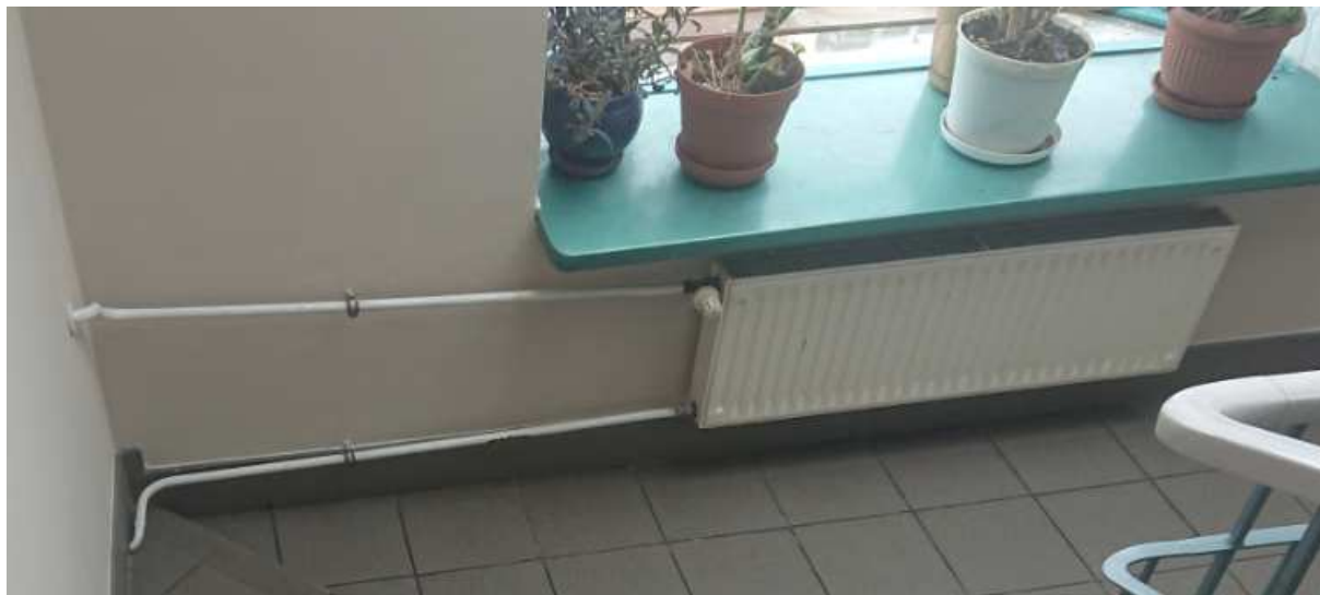
Fotografia 2 Podłączenie typowego grzejnika na klatce schodowej
